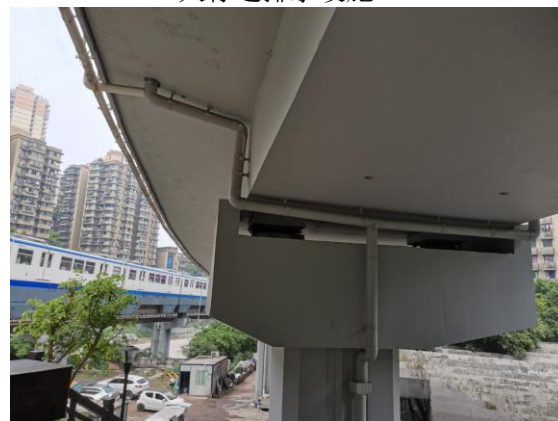
高架段雨水导排系统
