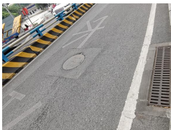
车行道排水设施
