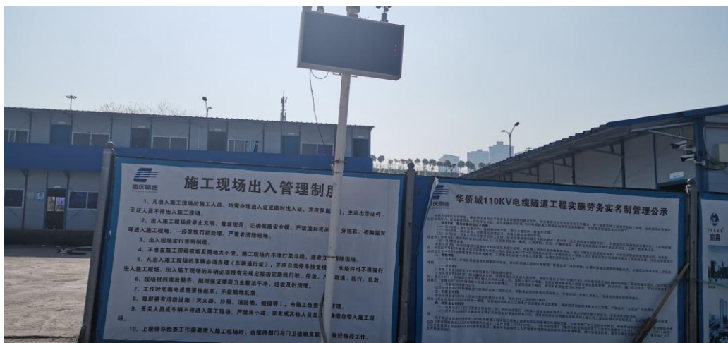
施工现场扬尘、噪声在线监测仪
